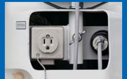
100V 電源取出口
